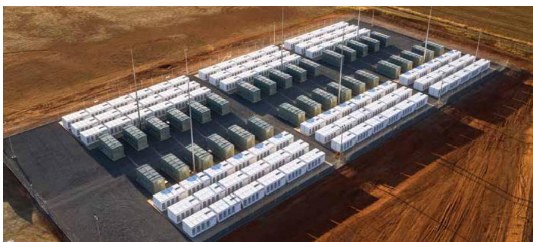
Σχ. 3. Σταθμός συσσωρευτών Li-Ion 100 MW / 129 MWh στην Αυστραλία [5].
